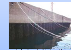
老朽化した岸壁の状況
