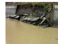
側壁が倒壊した水路
