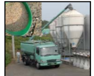
飼料保管タンク
