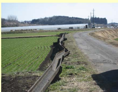
地震により受台から落下した水路
