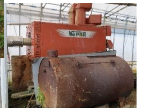
ハウスの暖房設備
