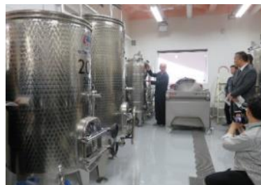
【発酵室の設備】
