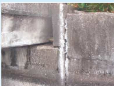
▲開水路の不等沈下による段差
