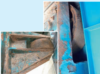
▲新田原井堰のゲートローラー部が腐食
