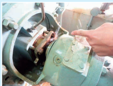
▲揚水機場ポンプ設備の性能低下
