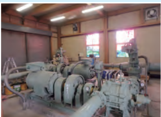
▲浮田玉井揚水機場
