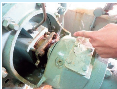
▲揚水機場ポンプ設備の性能低下
