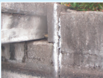
▲開水路の不等沈下による段差
