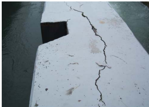
東西分水工の側壁の亀裂
