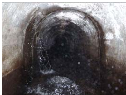
隧道のクラックからの漏水
