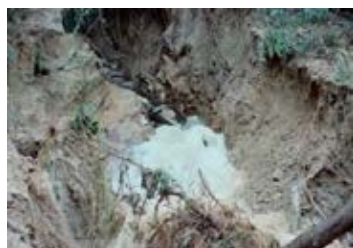
道後南部幹線水路(久谷サイホン) 石綿セメント管破裂(撮影S54)
