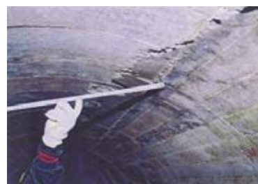
道後導水路 トンネルアーチ部に亀裂(撮影H14)
