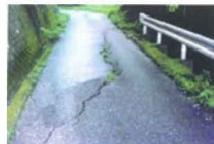
地すべりにより発生した亀裂や沈下
