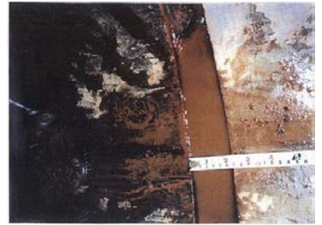
継手部の劣化による抜け出し (今後、漏水が懸念)
