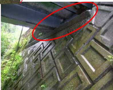
開水路(水路橋)継手部からの漏水
