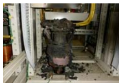
機器の誤作動による焼損事故（伊方2号支線揚水機場の電動機始動器）
