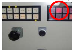
状態表示ランプの誤作動（故障ランプの異常点灯）
