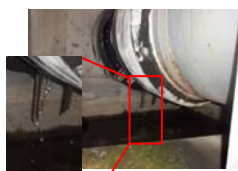
管継手部からの漏水
