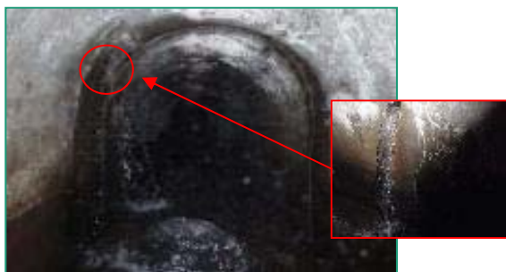
隧道内のひび割れからの漏水状況
