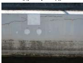
開水路のひび割れ
