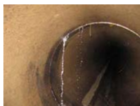
経年劣化による継手の漏水
