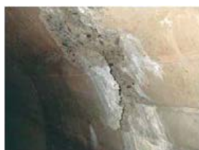
暗渠部の変状
