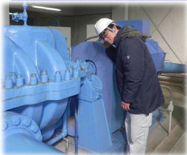
【聴診棒によるポンプ設備の機能診断】
