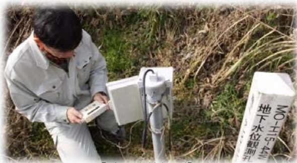
【地下水位観測】
