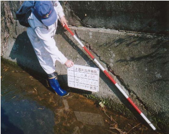
ひび割れ状況
