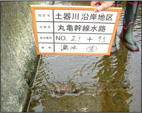
底版目地部からの漏水
