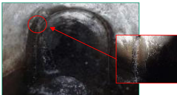
隧道内のひび割れからの漏水状況
