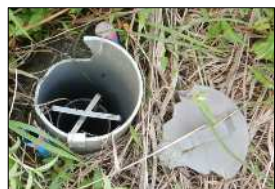
草刈り時に破損
