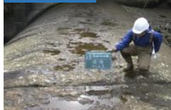
固定堰の摩耗
