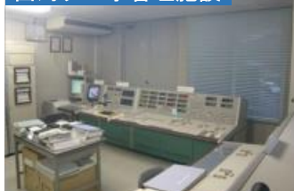
水管理施設の劣化
