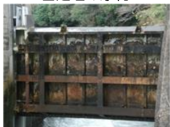
ゲートの劣化
