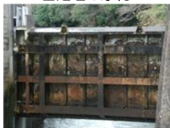
ゲートの劣化
