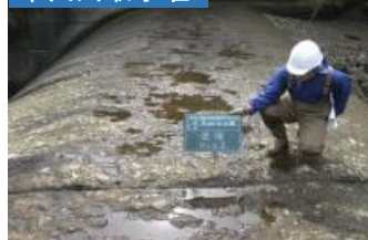
固定堰の摩耗
