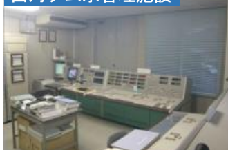
水管理施設の劣化
