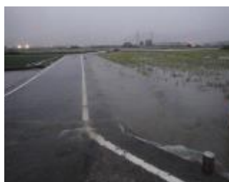
既設水路溢水 (田野上方東団地)
