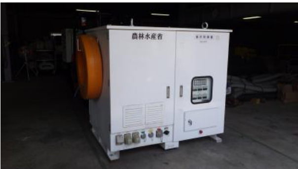
排水ポンプパッケージ (操作盤側)
