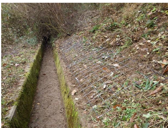
水路脇法面のイノシシによる掘り起こし 防止対策（水路への土壌流入を防ぐ）
