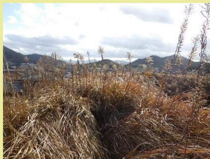
草が繁茂した堤上部
