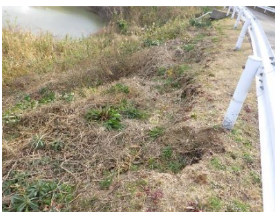
崩された道路法面
