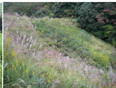
堤体法面の草が生い茂っている
