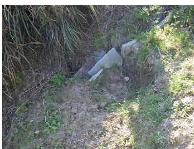
壊された水路
