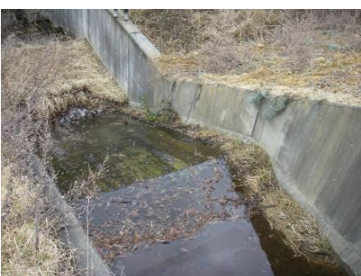
落とされた土砂が堆積した余水吐
