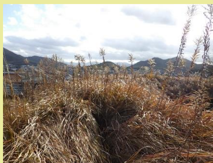
草が繁茂した堤上部
