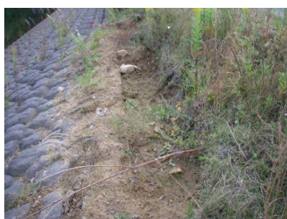
ため池の護岸沿いの掘り跡
