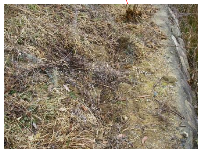
護岸沿いの掘り跡
