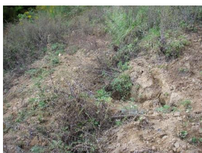
ため池法面の掘り跡
