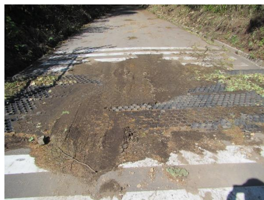
雨で土砂に埋まったグレーチング
